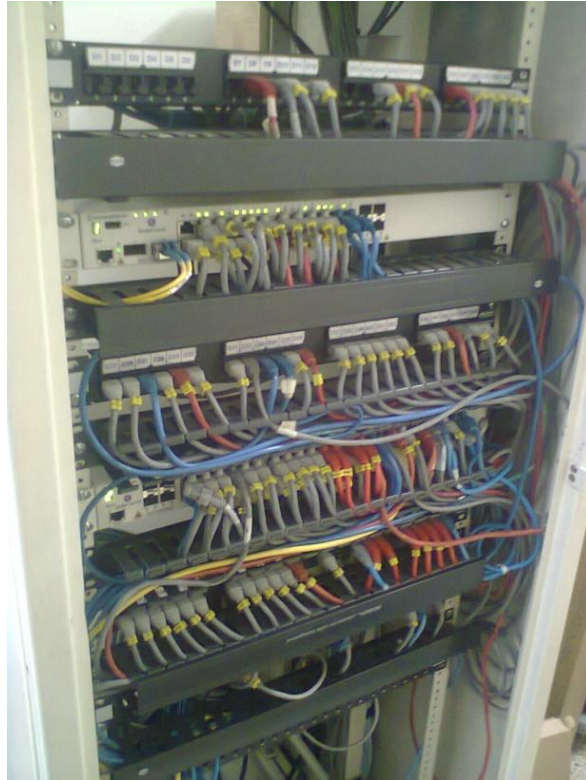
Figura 8. Fotografía del rack que cubre las oficinas de Informática, Catastro y Sótano Municipal.
