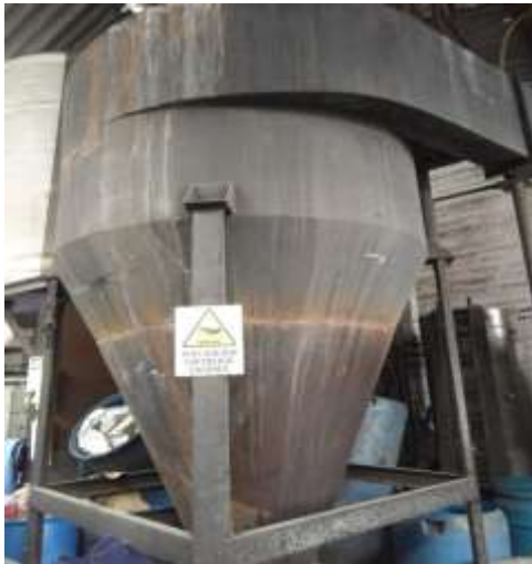
Figura Nª 9. Calderas de secado
