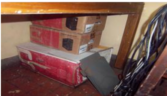
Figura 13 Humedad toda la Seccion3.
