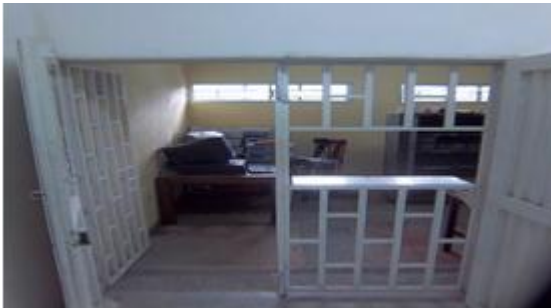
Figura 9 Sección 3 Cuarto de Equipos.
