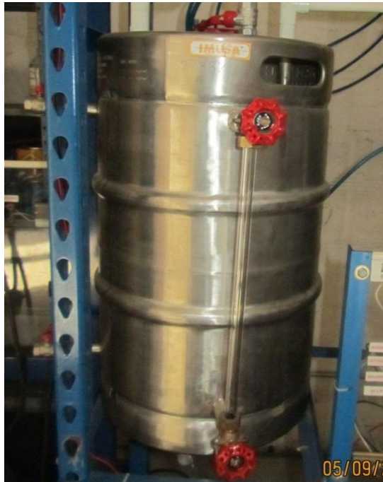
FIGURA 27: Tanque de presión
