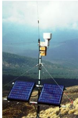
Figura 8 Estación Repetidora alimentada con paneles solares
